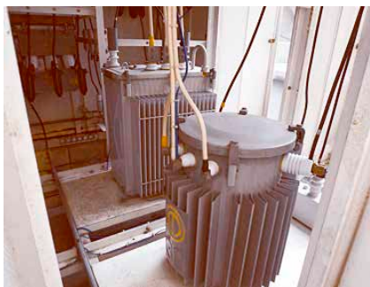
変圧器の一例
