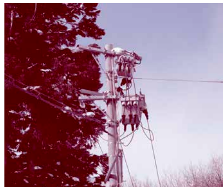
雪を除去した後、PAS取り付けの腕金が雪の重みで曲がってしまいました
