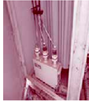
水没した高圧コンデンサ
